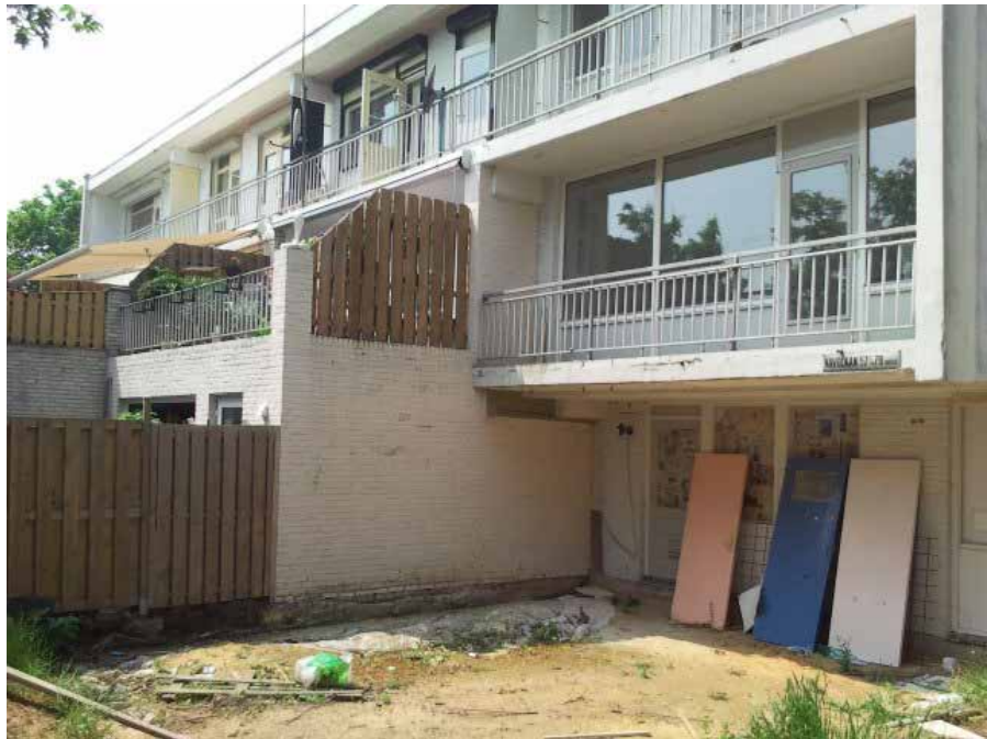
Impressie achterstallig onderhoud
